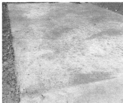
Foto 3: En la foto que se observa la parte de reparación de banquetas de concreto que requiere el Centro Educativo.
