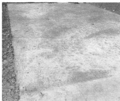
Foto 3: En la foto que se observa la parte de reparación de banquetas de concreto que requiere el Centro Educativo.
