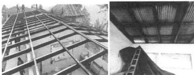
Foto 1: En la foto que se observa, que se ha retirado la lámina del techo escolar.
